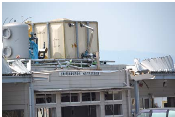
修理場の近くの被災した漁協施設
